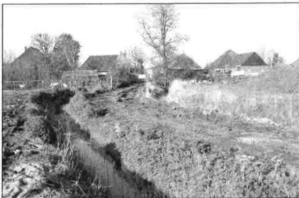
Figuur 5 De Waldijk richting Assum. Wegens een asbestsanering is hier de bovenlaag van de dijk verwijderd.
